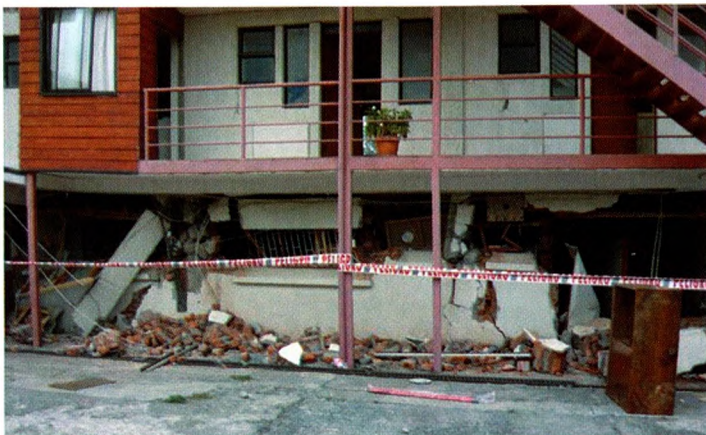
Figura 9: Colapso de primer piso en edificio de albañilería de 3 pisos
