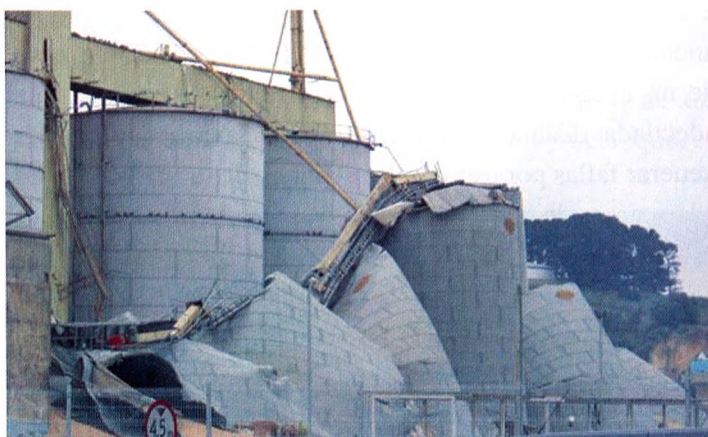
Figura 12: Colapso de silos de almacenamiento de trigo en sector Costanera
