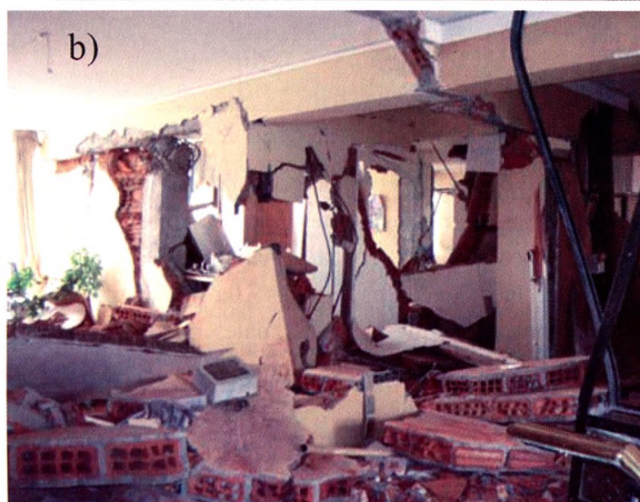
Figura 8: a) Edificio de 11 pisos en la Plaza de la Independencia y b) piso 9 colapsado
