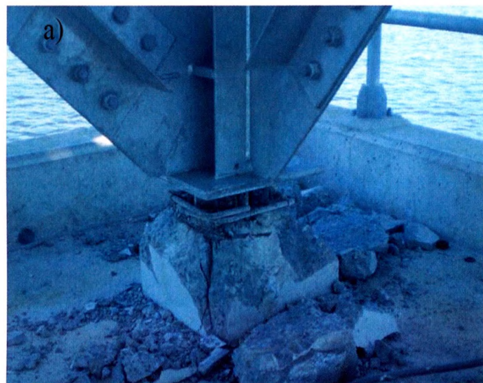
Figura 19: Fallas en pedestales de hormigón armado
