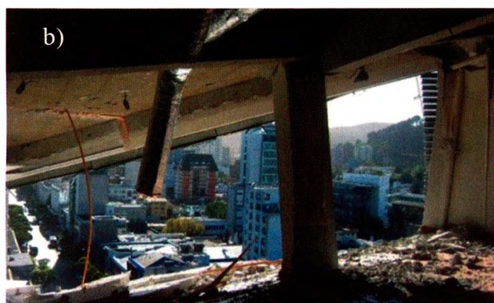
Figura 11: a) Fallas de columna corta en eje perimetral y b) colapso de columnas de entrepiso perimetrales provoca caída de losas con grandes luces libres
