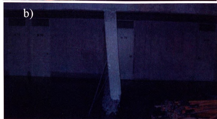
Figura 4: Muros de un edificio de 12 pisos ubicado en suelo blando a) y b) falla en la base
