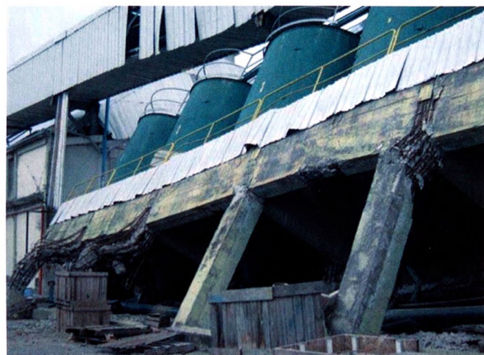
Figura 18: Colapso de altillo de hormigón armado con gran carga de peso propio (tomado de Hidalgo, 2010)
