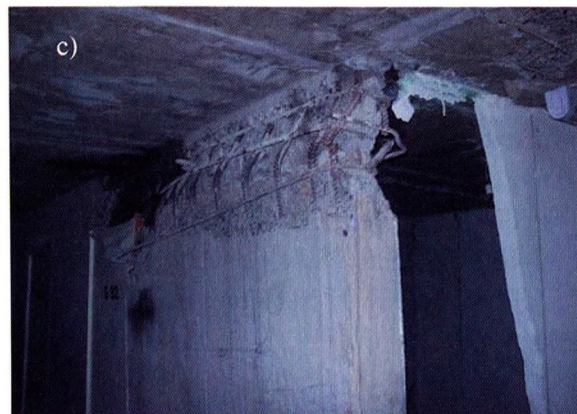
Figura 4: Muros de un edificio de 12 pisos ubicado en suelo blando c) falla en la parte superior
