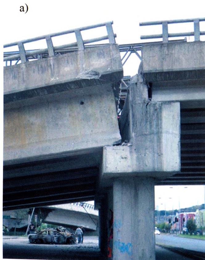
Figura 21: Colapso vigas y tablero de aproximación en acceso puente Llacolén, a) cepa de apoyo
