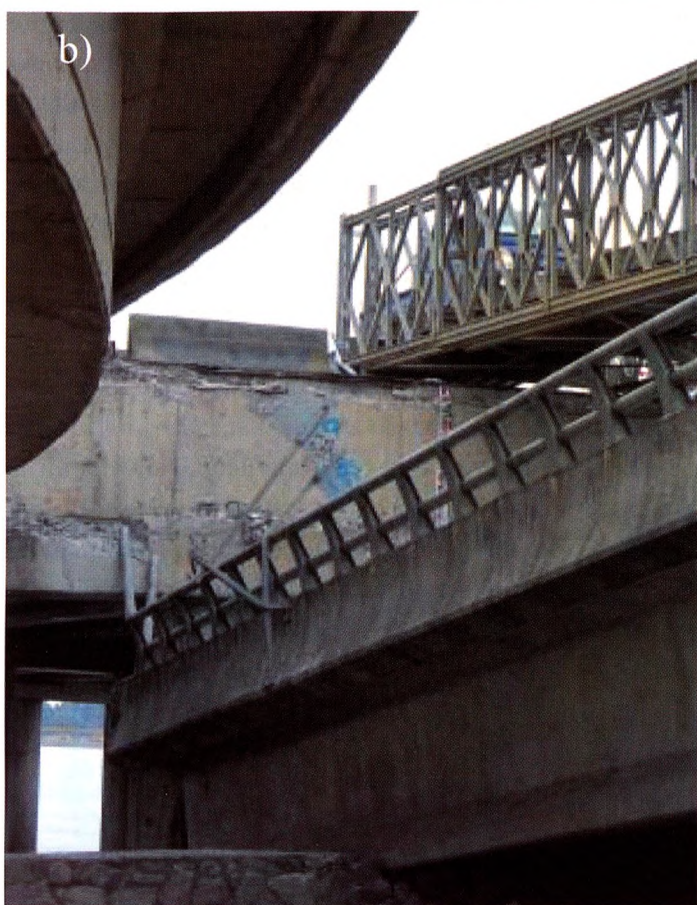
Figura 21: Colapso vigas y tablero de aproximación en acceso puente Llacolén, b) caída en apoyo de estribo del puente
