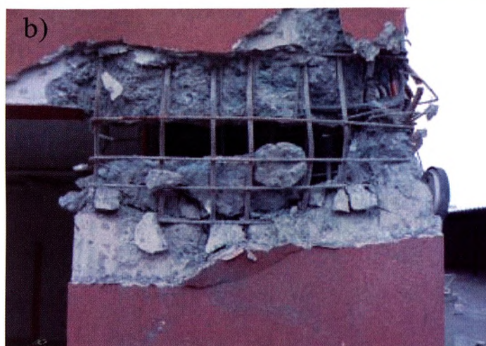
Figura 6: Columnas perimetrales falladas del edificio de 17 pisos, se observa pandeo de armadura vertical (Betanzo 2010)
