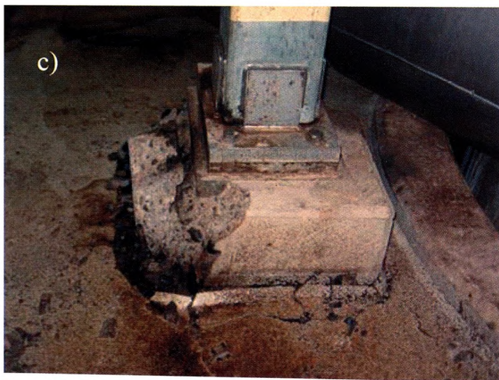
Figura 19 (continuación): Fallas en pedestales de hormigón armado
