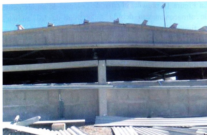
Figura 20: Anclajes deficientes en elementos prefabricados
