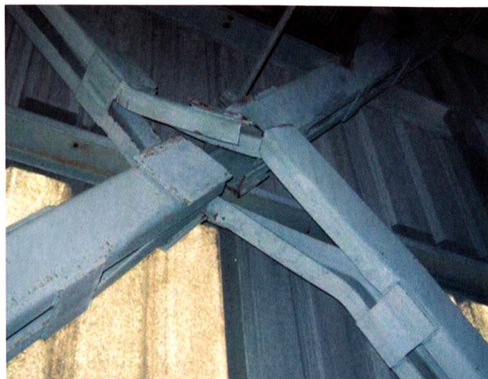
Figura 17: Falla por inestabilidad de diagonal sísmica (tomado de Hidalgo 2010)
