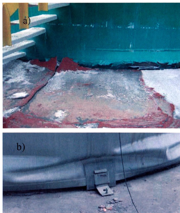
Figura 13: Falla tipo “pata de elefante” en estanques con manto continuo (tomado de Herrera 2010)
