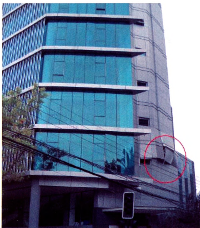
Figura 7: Edificio de 24 pisos de no más de un año de construido presenta una rotura tapada por cubierta (Betanzo 2010)
