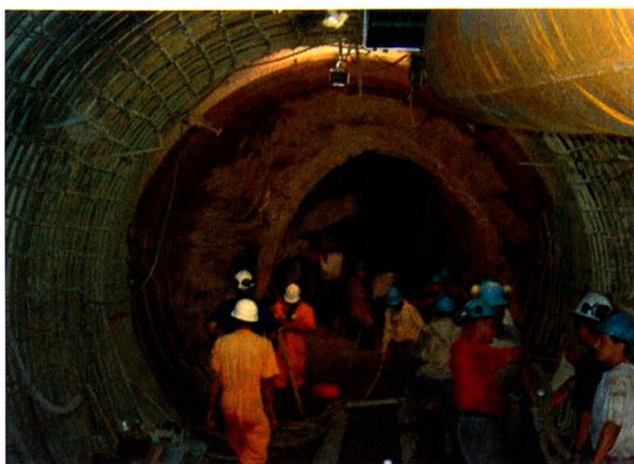
Figura 5: Clásica foto que documenta el cierre de la sección del túnel por squeezing de las filitas. Proyecto Yacambú-Quibor
