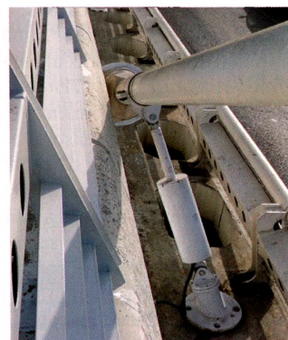
Fig. 23 Amortiguadores MR en Puente Alamillo, Sevilla, España. Foto: G. Valdebenito
