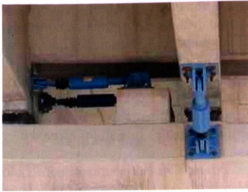
Fig. 19 Disposición del sistema de aislamiento elastomérico y disipación de energía longitudinal y transversal [Foto: Cortesía de FIP Industriale, Italia]
